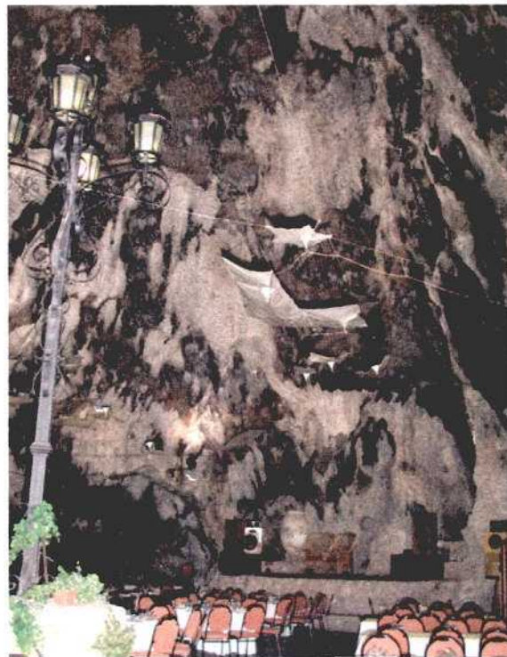
Vista de la sala, con el escenario al fondo y dispositivos de recogida de agua de goteo (Foto 4)
